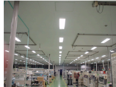
Sistema di illuminazione
